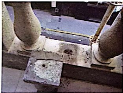
Patologías. Estado balaustres
