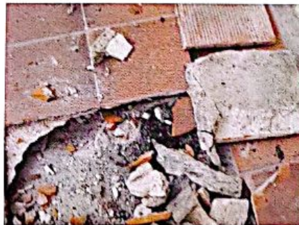
Estado del solado existente en el 8º piso.
